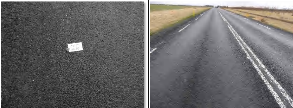
Mynd 75 Nærmynd ofan í kafla með fog-seal a) og yfirlitsmynd af kaflanum b)
