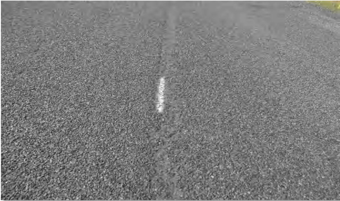
Mynd 38 Saumskemmd er greinileg við stöð 139 – of lítið bindiefni
